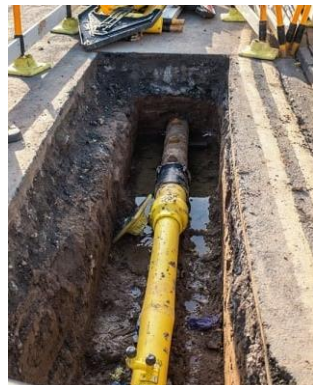
Constat : certains réseaux sont très abîmés
